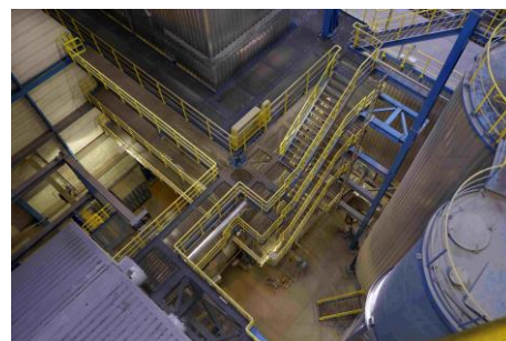
Die Filteranlage von oben
