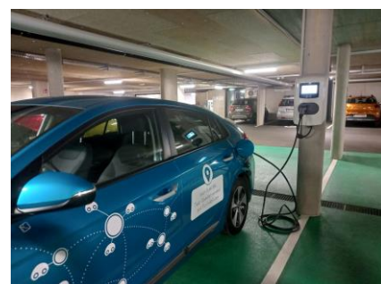
Parkplatz mit Ladestation in der Tiefgarage der Gemeinde
